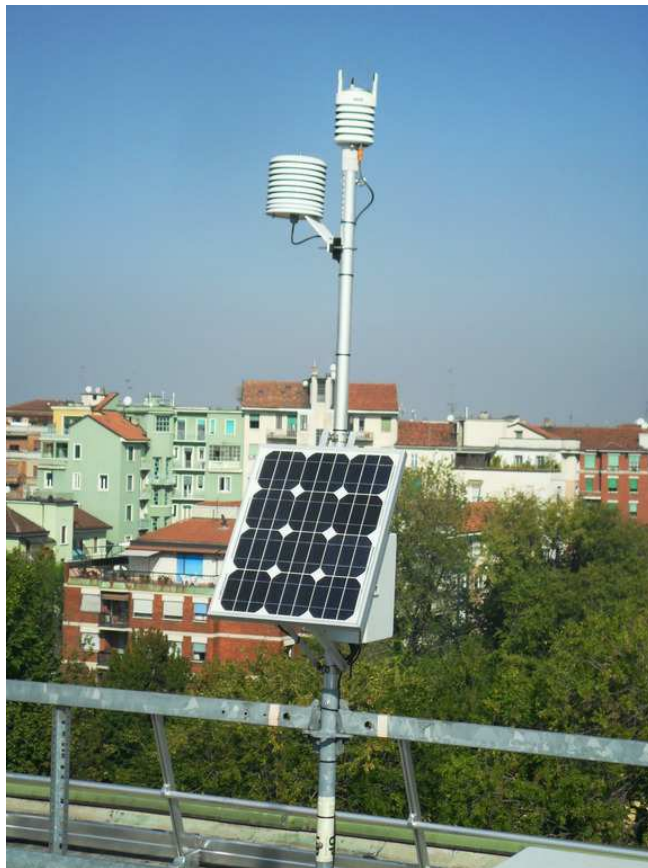
Figura 2.5 Stazione meteo installata sul tetto dell'edificio 14
