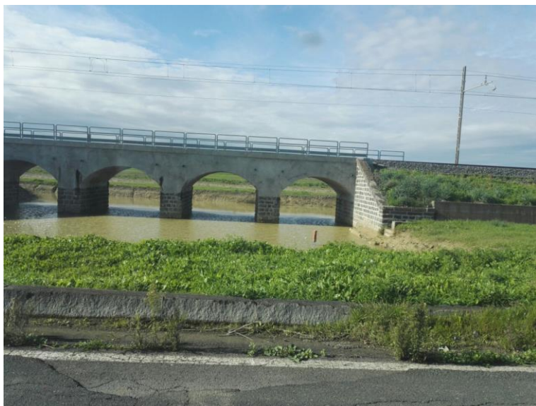
Figura 19. tratto della SS194 soggetto ad inondazione
