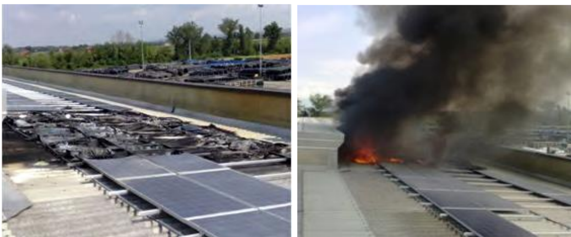
Figura 52 – Esempio di incendio di parte di impianto FV in copertura.
