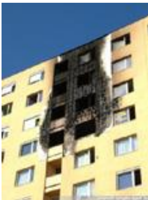
Figura 44 – Incendio lungo la facciata a cappotto, a Miskolc in Ungheria.
