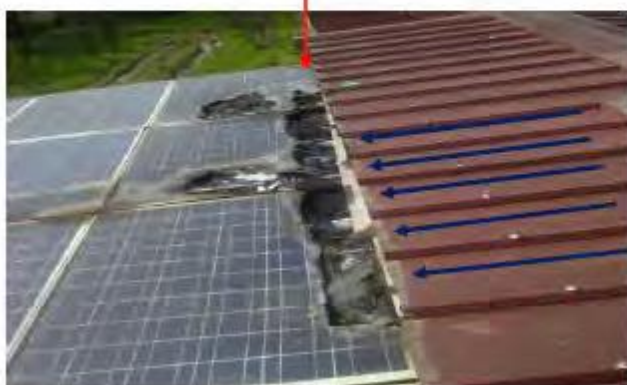
Figura 60 – Cortocircuito generato da perdita di integrità del telaio a causa dell'acqua piovana.
