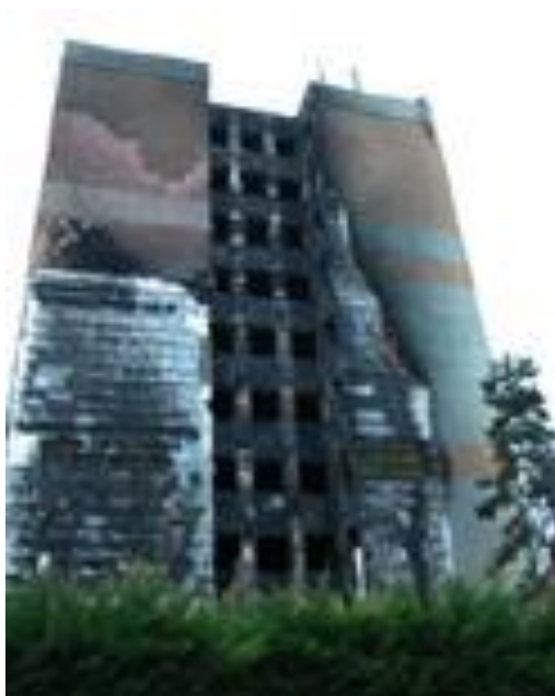
Figura 45 – Propagazione dell'incendio lungo la facciata, a Dijon in Francia.
