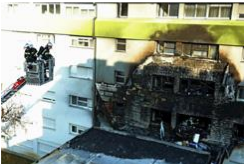
Figura 47 – Diffusione delle fiamme dal tetto fino in facciata, a Zagreb.
