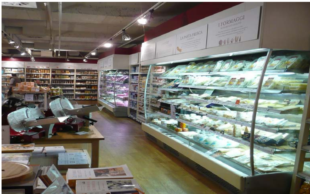
Fig. 194 Interno shop di Milano – espositori refrigerati
