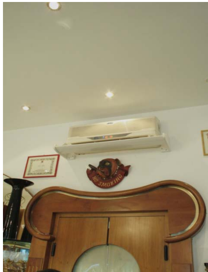
Fig. 336 (destra) Interno - climatizzazione a split
