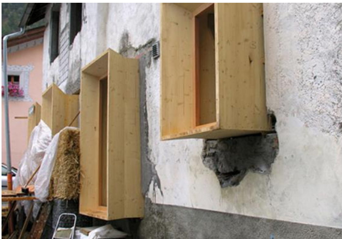
Figura 2.44: Dettaglio costruttivo dell'adeguamento dei profili in legno per le finestre a causa dello spessore del cappotto in paglia
