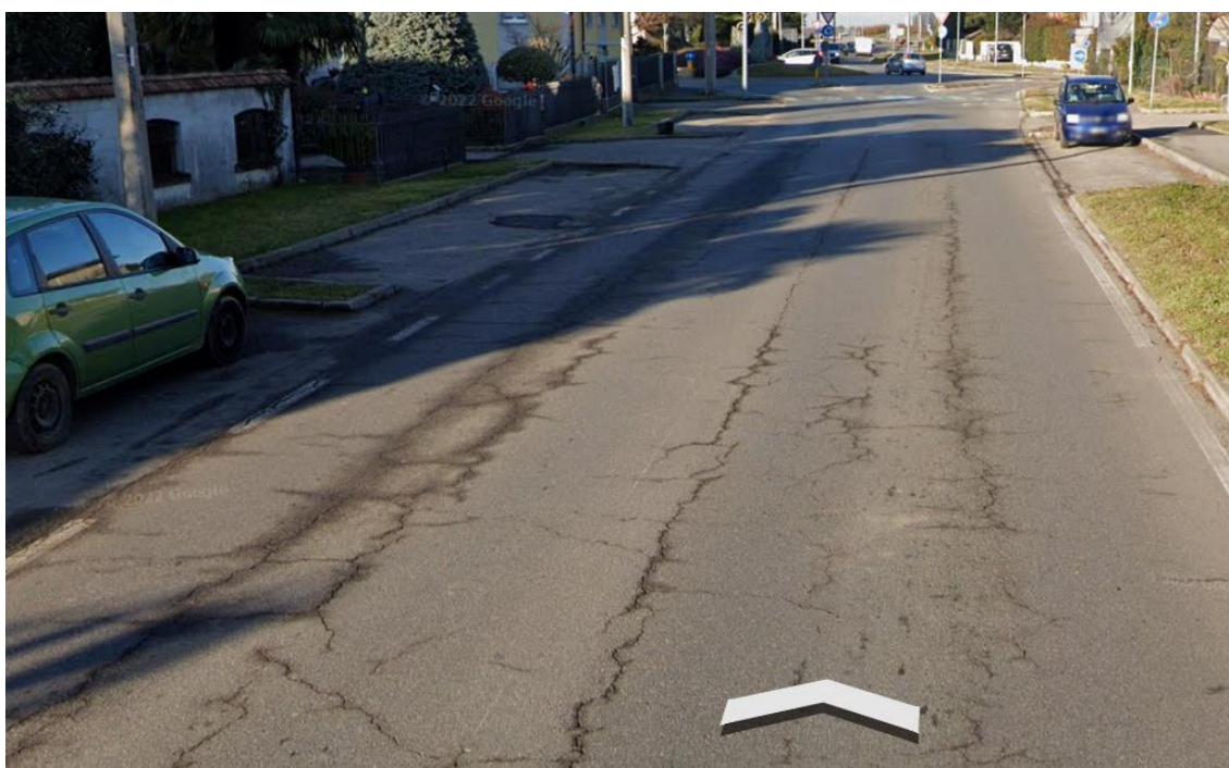
Figura 43 - Fessure lungo la pavimentazione
