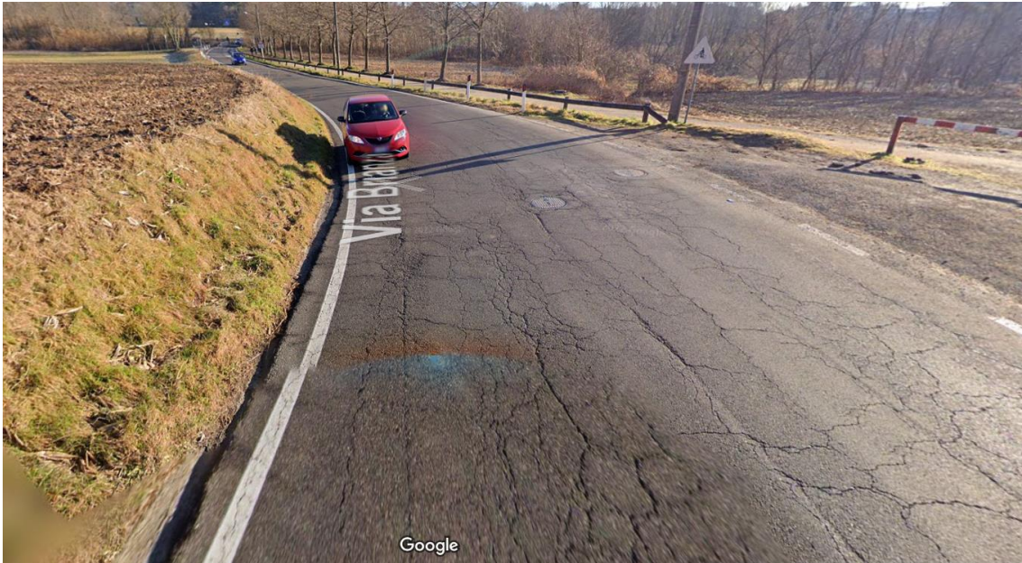
Figura 38 - Fenomeno di Fessurazione per fatica sul manto stradale
