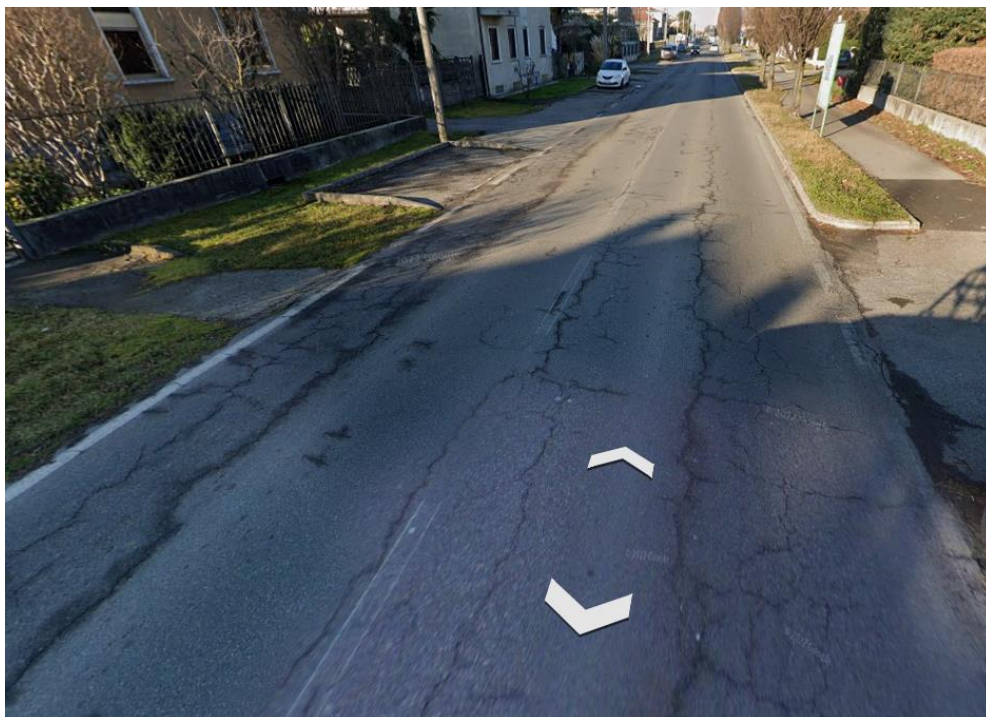
Figura 42 - Fessure lungo la pavimentazione
