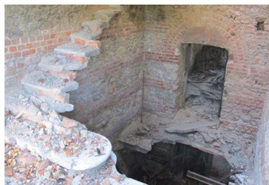
Figura 3.22: Vista interna delle scale ormai crollate. Foto dell'Ing. Lorenzo Jurina, 2011.
