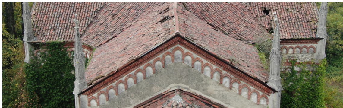
Figura 3.13: Particolare della facciata est rivestita parzialmente con intonaco. Foto IMS Droni: Alessio Villa, novembre 2020.
