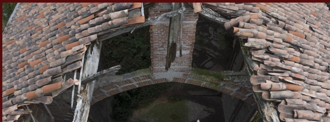
Figura 3.8: Vista attraverso il cedimento della copertura ad ovest dell'interno. Foto di IMS Droni: Alessio Villa, novembre 2020
