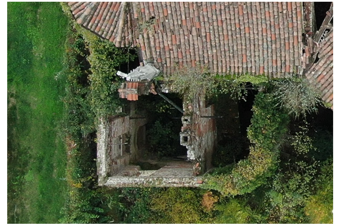
Figura 3.20: Vista aereo della parte completamente crollata. Foto di IMS Droni: Alessio Villa, novembre 2020
