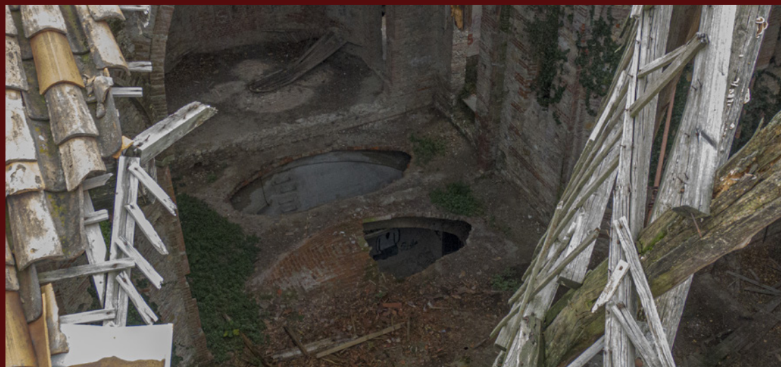
Figura 3.6: Vista attraverso il cedimento della copertura del primo piano. Foto di IMS Droni: Alessio Villa, novembre 2020
