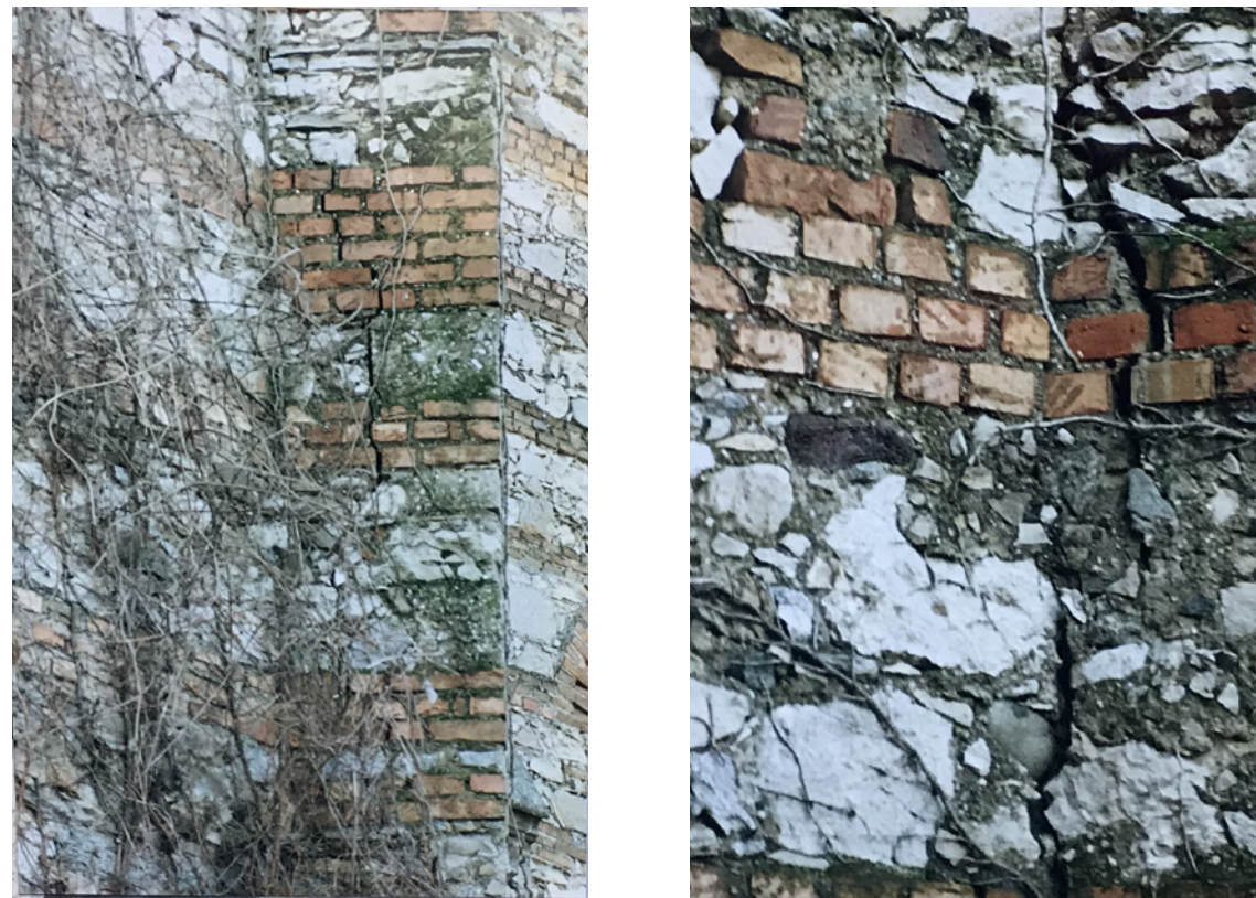
Figura 6.20 - 6.21: le fratturazioni presenti sui contrafforti in corrispondenza delle intersezioni murarie
