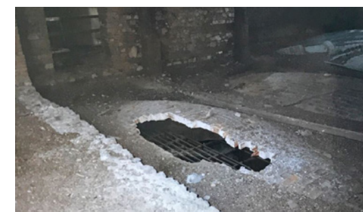
Figura 3.24: Particolare delle volte cedute del primo piano, foto dell'Arch. Paolo Gatti, 1994
