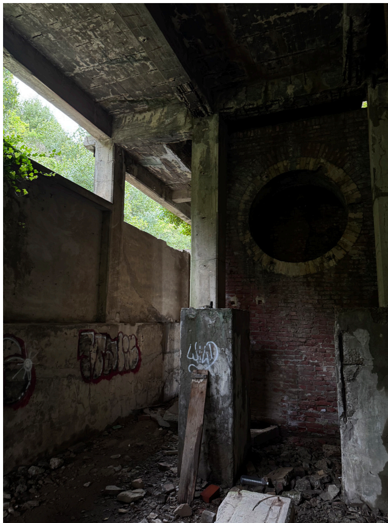
Edificio del forno rotante, vista interna, 2025
