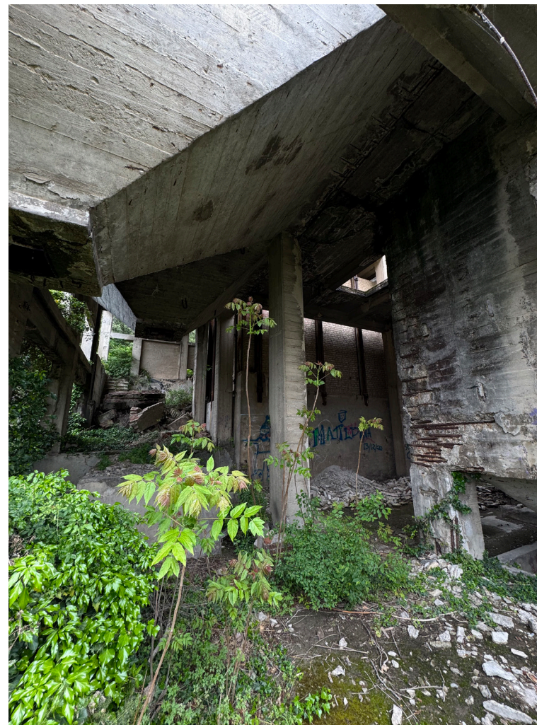
Edificio del forno rotante, vista interna, 2025
