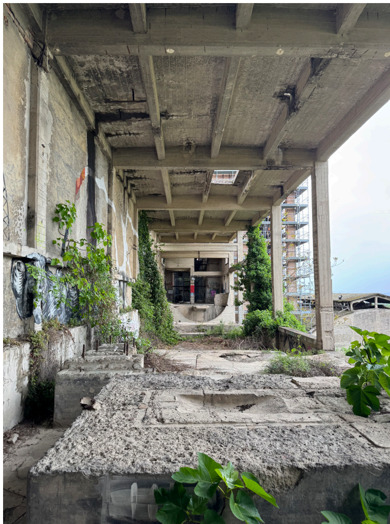
Edificio del forno rotante, vista interna, 2025
