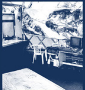
BIVACCO Alcune parti dell'edificio sono state occupate da extracomunitari clandestini che vi hanno portato materassi, mobili, fornelli, come in una vera e propria casa
