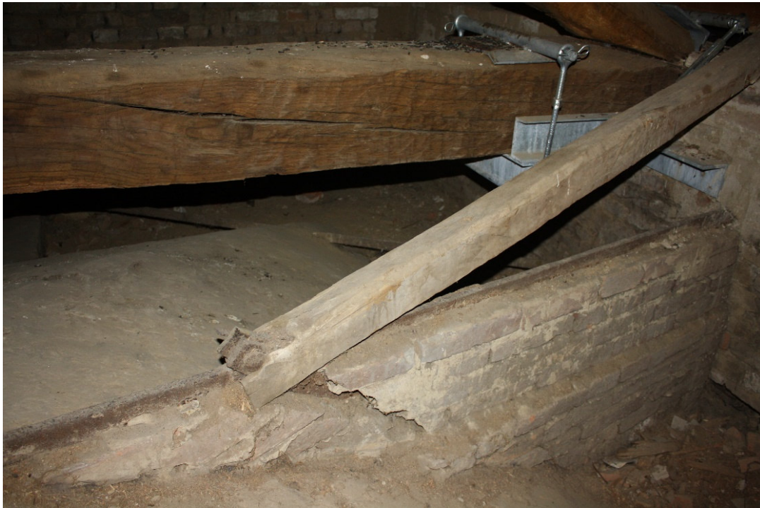
Figura 3-18: Fessurazione diagonale nel frenello
