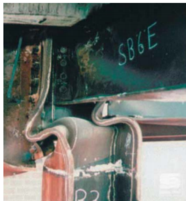
Figura 1.14: Estremità di un pilastro d'acciaio fortemente deformato dopo un incendio.
