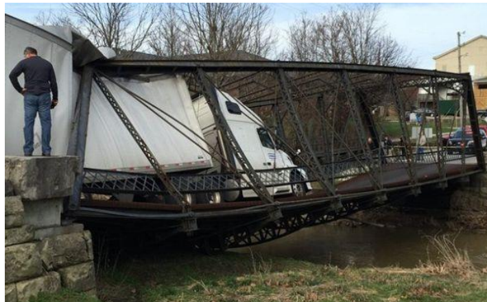
Figura 115- Veicolo troppo pesante (foto di sinistra), il ponticello non regge fonte: www.autoblog.it
