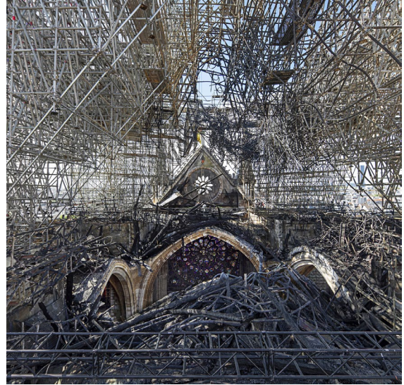
Figura 14 – Vista della cattedrale dopo l'incendio [9]
