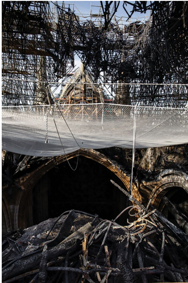
Figura 93 – La cattedrale dopo l'incendio [19]
