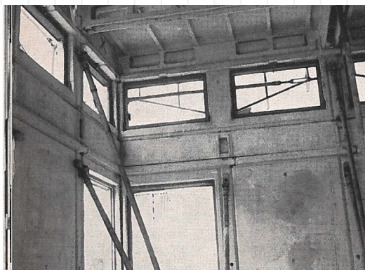
fig.41 vista interna dell'aula laboratorio realizzata per la Facoltà di Architettura di Roma. Sono visibili i puntelli telescopici metallici regolabili per il fissaggio dei pannelli e gli elementi sfinetrati ad essi sovrapposti e simili per strutture
