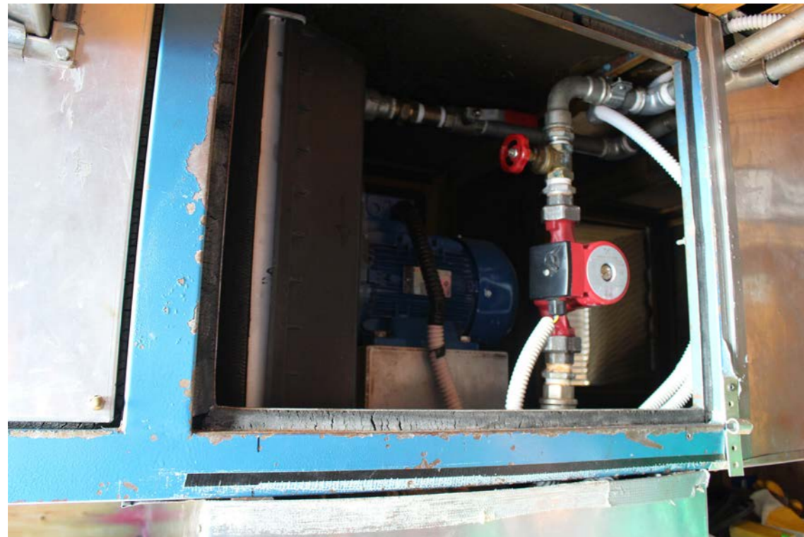
Fig.3.48 Particolare della pompa di gestione dell'impianto di riscaldamento.
