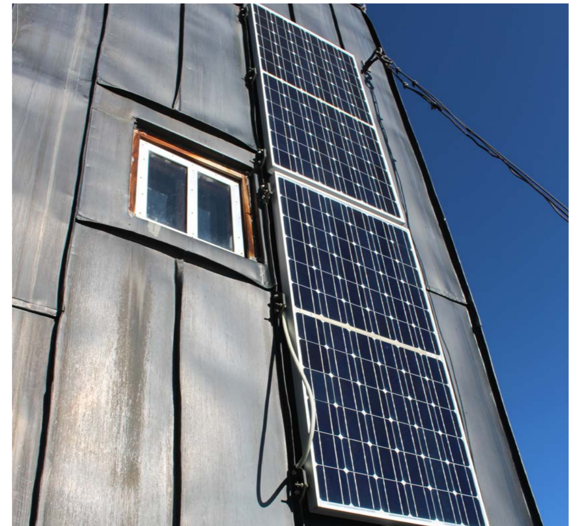
Fig.3.48 Pannelli fotovoltaici posizionati sulla facciata sud-est.
