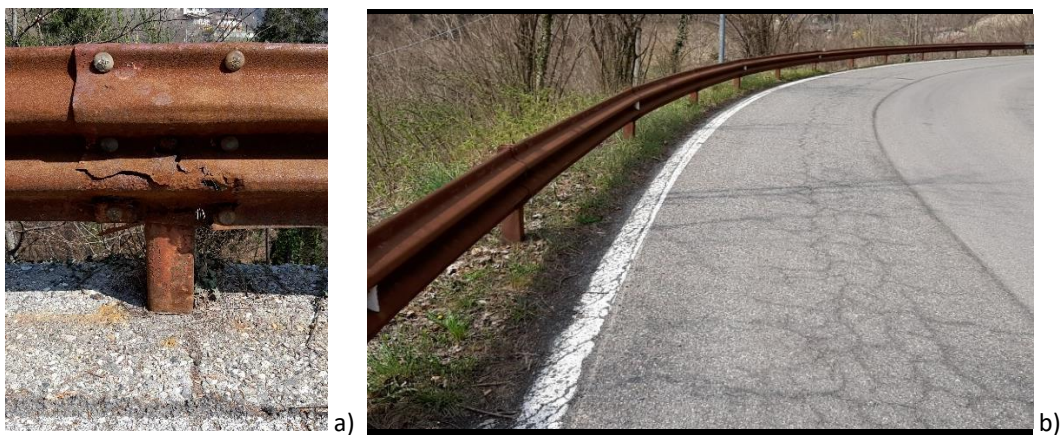
Figura 31 Corrosione del nastro: a) diminuzione della sezione resistente b) intaccata la sezione resistente
