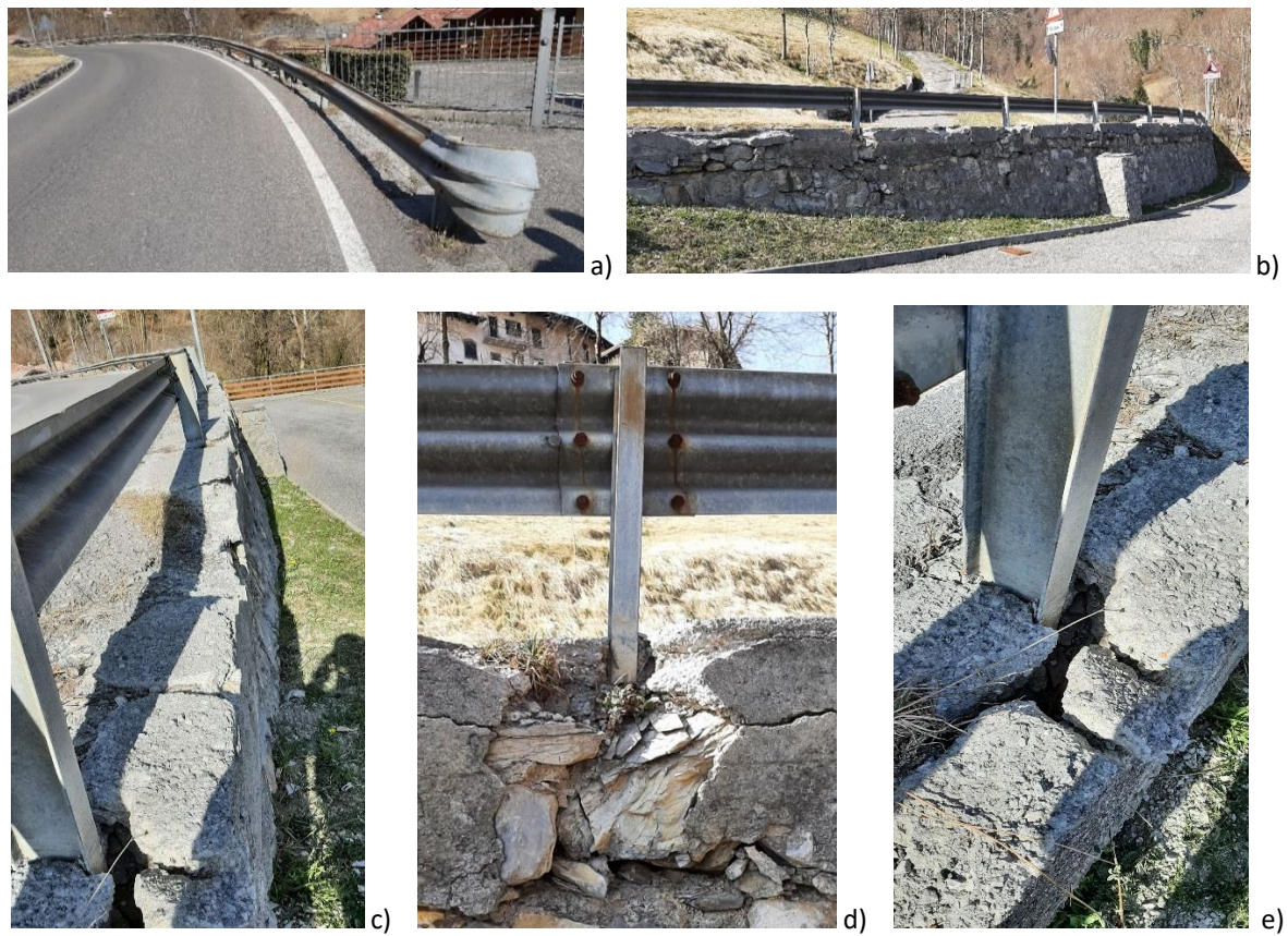
Figura 42 Rilievo fotografico di una tratta della S.P.46: a) Nastro ossidato b) muro di sostegno ammalorato c), e) cordolo rotto d) perdita del vincolo di incastro del montante nel cordolo
