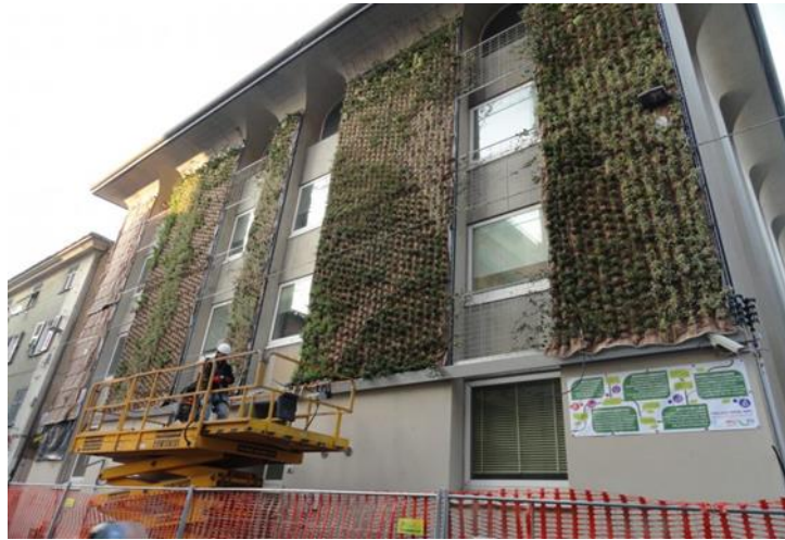
Figure 14: Istituto Nazionale di Previdenza Sociale- Living Wall System Installation
