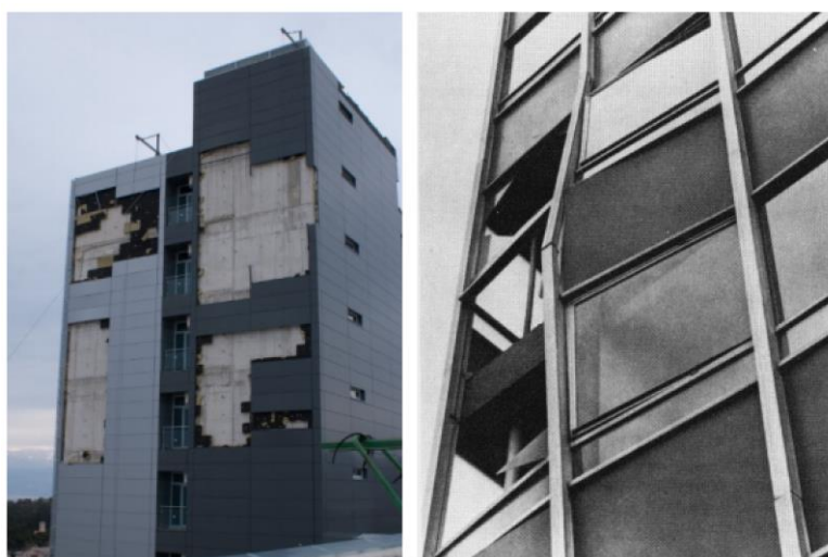
Figura 3—11: Collasso di elementi di facciata in prossimità degli spigoli, per azione di fenomeni di depressione.
