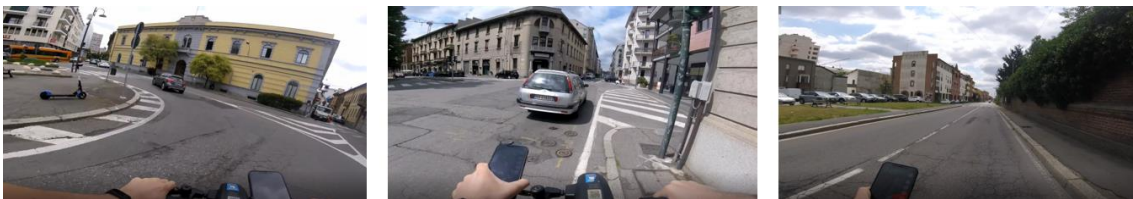
Figura 89 - Immagini video di problemi legati alla pavimentazione
