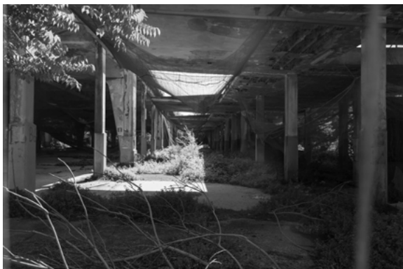
10. Vegetazione infestante e degradi strutturali: mercato delle carni
