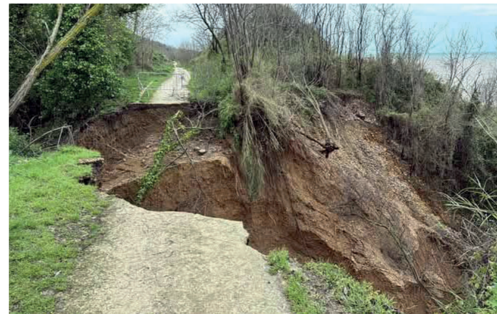
Figura 30 - Frana della Via Verde in corrispondenza di Mottagrossa verificatasi il 28 Marzo 2025 e aggravatasi il 31 Marzo
