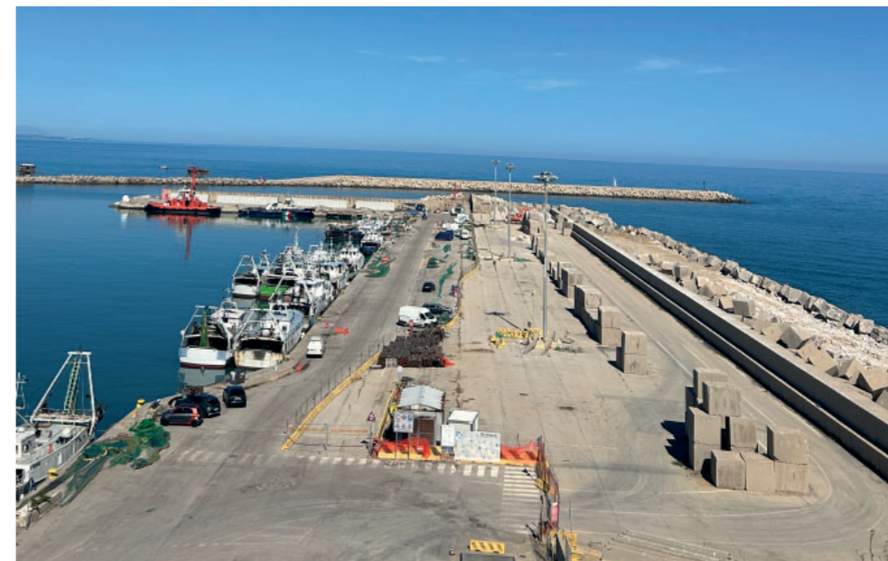
Figura 5 - Banchina del molo di Levante a seguito dei lavori di ampliamento, 20 Settembre 2025
