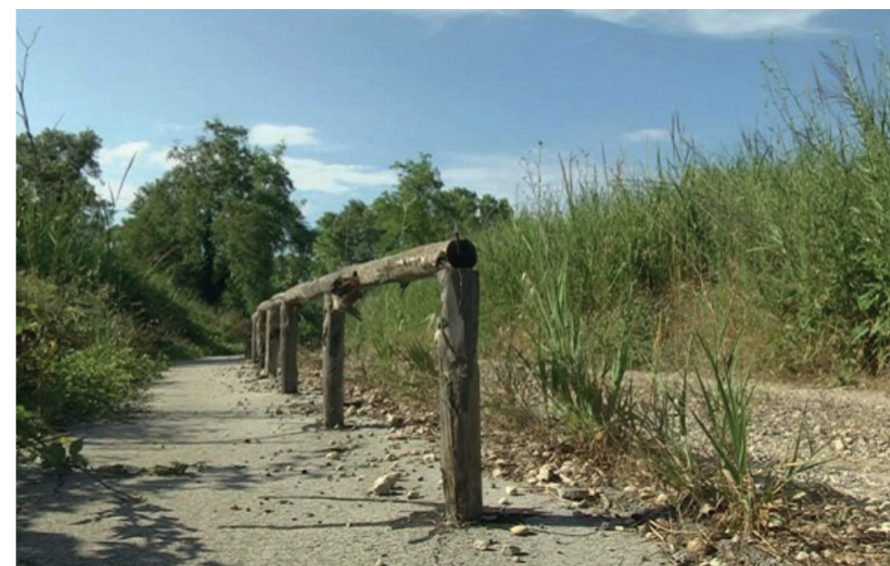
Figura 10 - Fondo stradale della pista ciclabile del Torrente Lebba deteriorato
