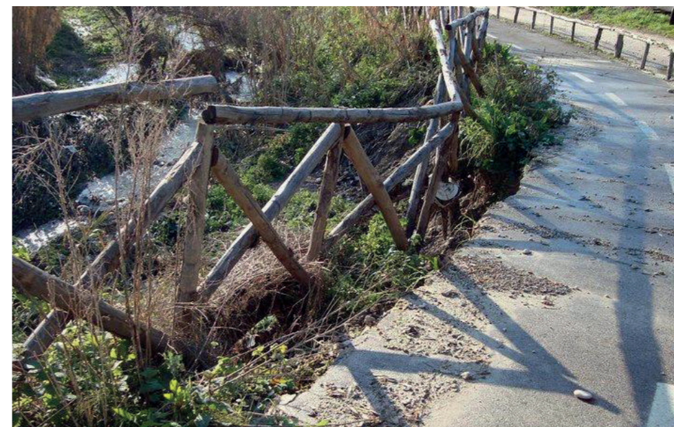
Figura 9 - Parapetto divelto lungo la pista ciclabile del Torrente Lebba
