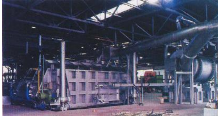
Fig. 1.16 Forno fusorio di grosso tonnellaggio
