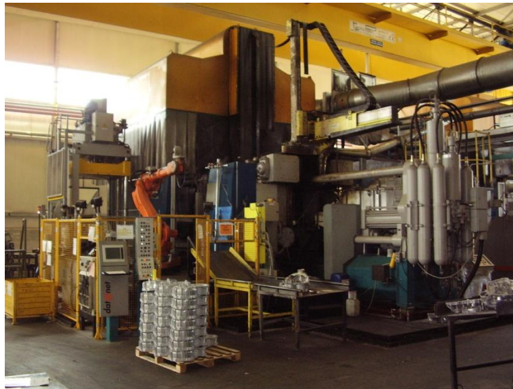
Fig. 2.3 Macchina da pressofusione 1800t integrata nell'isola
