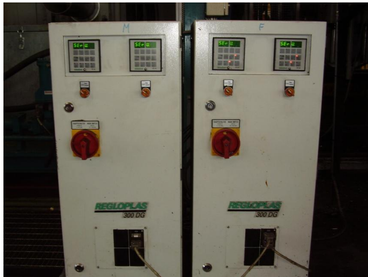
Fig. 7.5. Centraline di termoregolazione
