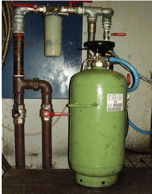
Fig. 3.6 Serbatoio per lubrificazione manuale
