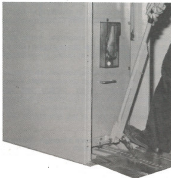
Figura 3 Manovra manuale dell'interruttore nel pannello Univer G effettuata con porta aperta
