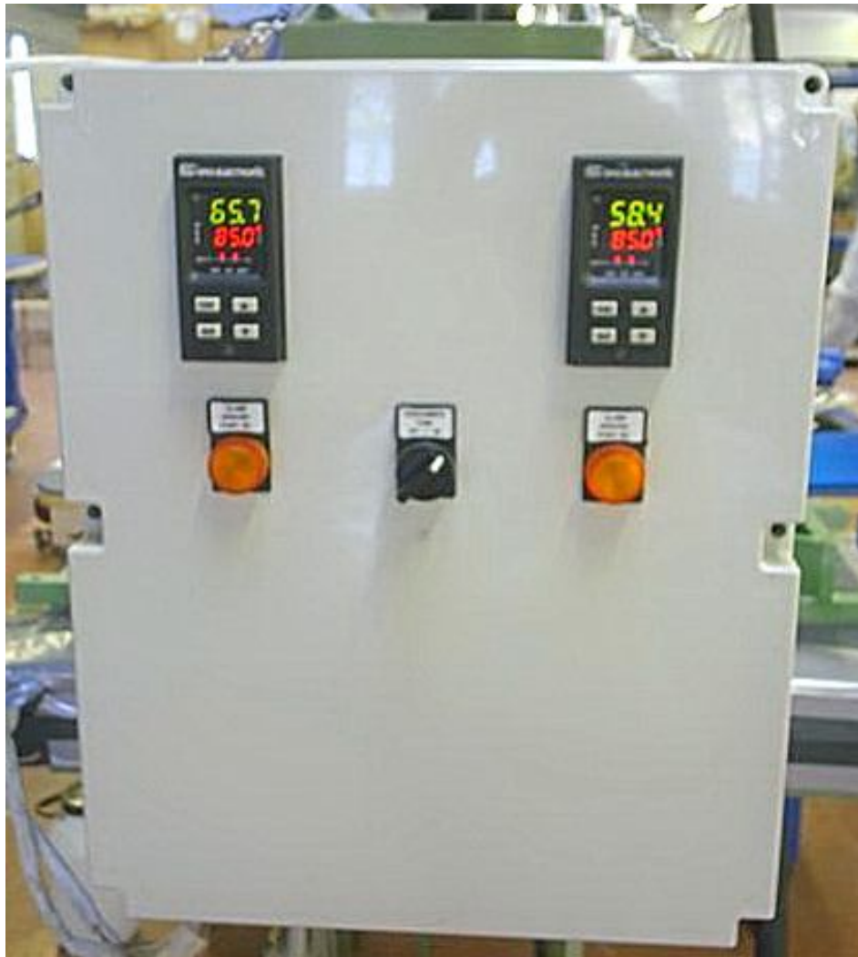
Fig. 5.12: quadro elettrico di controllo automatico temperatura stampi
