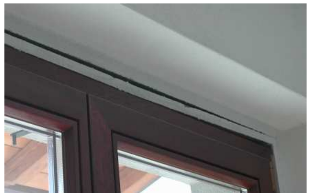
Fig. 28 Esempi di sistemi di cattiva posa
