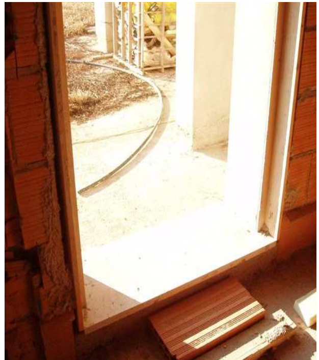
Fig. 27 Esempi di sistemi di cattiva posa
