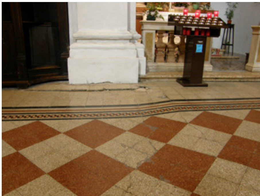
Fig. 195. I problemi strutturali del pavimento.
