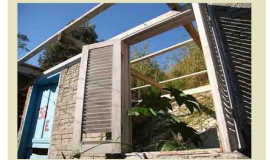
PARTICOLARE ABITAZIONE DEGRADATA
