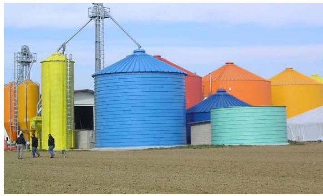
39. Impianto per la produzione di biogas
