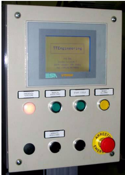
Figura 2.2: pannello di controllo della linea
