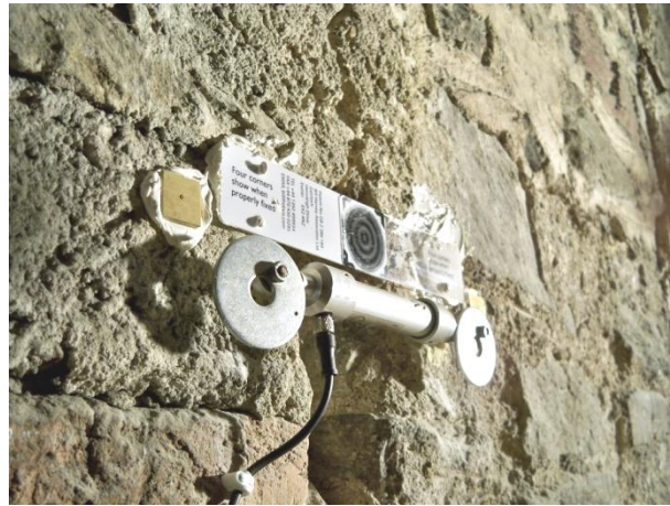
Figura 226 – Il fessurimetro moiré definitivamente incollato sulla fessura S3
