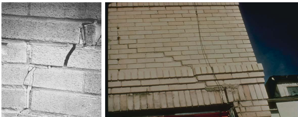
Figure 24 e 25 – Due esempi di fessure su murature portanti. A sinistra si può notare come la fessura abbia spaccato per primo il mattone. A destra invece un caso in cui il quadro fessurativo interessa quasi esclusivamente i giunti di malta
