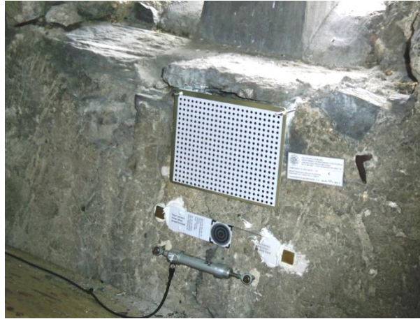
Figura 238 – La griglia di riferimento fissata sulle viti incollate nelle cavità della muratura
