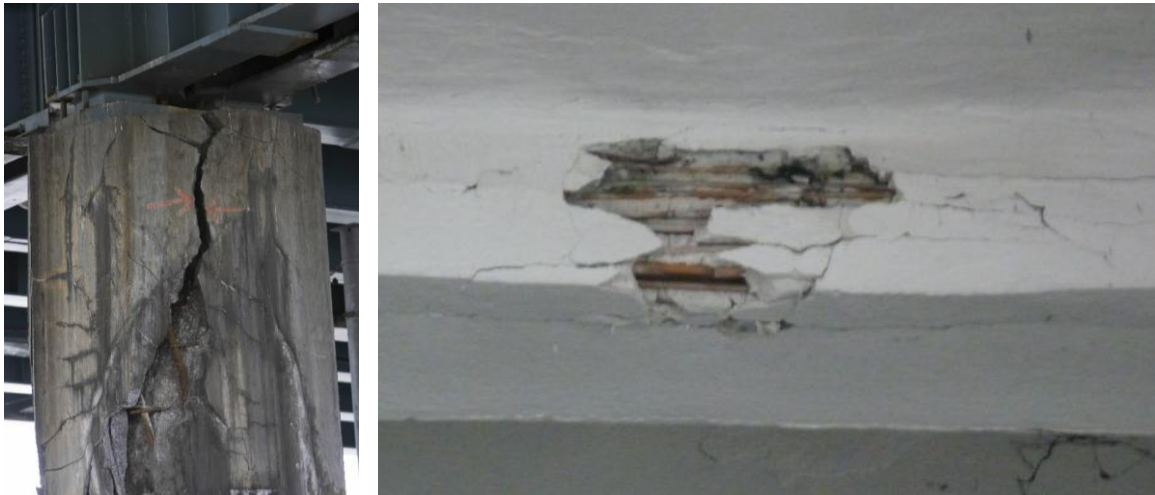
Figure 26 e 27 – Due esempi di fessure su elementi strutturali in calcestruzzo armato. A sinistra un pilastro di una grande struttura fessurato e vicino al collasso. A destra una trave (armatura in cannuce di legno) inflessa a causa dell'eccessivo sforzo a flessione si è fessurata ed espelle la sua porzione più esterna
