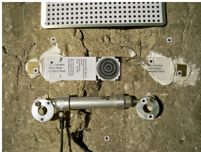
Figura 246 – Tutti gli strumenti applicati sulla fessura S2 (con l'aggiunta in basso dell'ultima mira)
