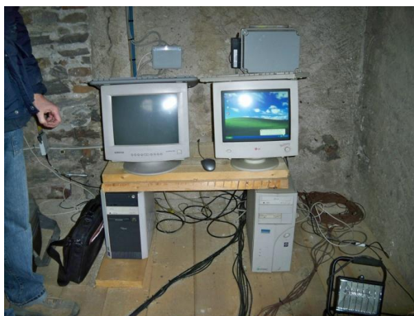
Figura 38 – Due computer per il sistema di acquisizione dei dati dinamici e statici in sito
