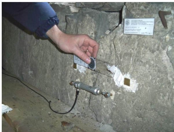
Figura 236 – La fase di incollaggio del fessurimetro moiré sulla muratura attraverso mastice solido per marmi
