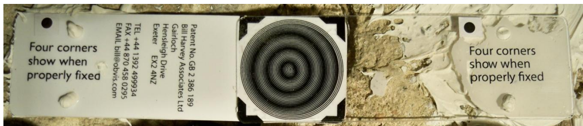
Figura 249 – Dettaglio del fessurimetro moiré incollato sulla fessura S3
