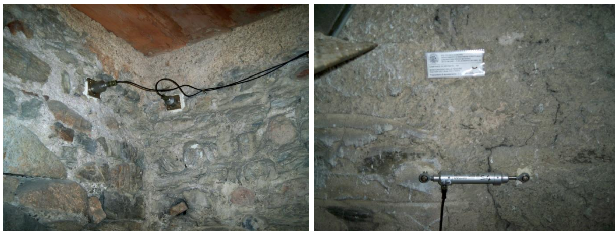
Figure 36 e 37 – A sinistra un esempio di strumenti per il monitoraggio dinamico (accelerometri). A destra un esempio di strumento per il monitoraggio statico (trasduttore potenziometrico)
