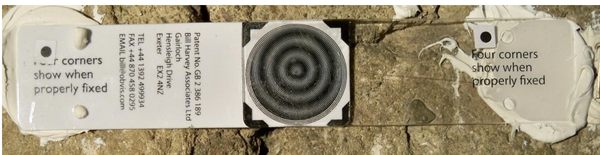
Figura 247 – Dettaglio del fessurimetro moiré incollato sulla fessura S2
