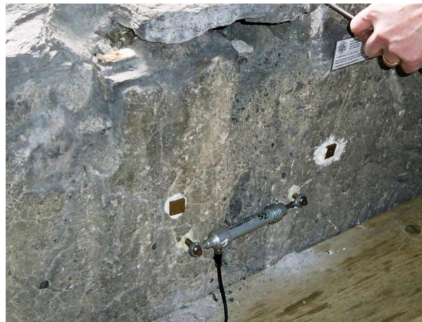
Figura 216 – Una fessura al quarto livello con un trasduttore potenziometrico e le basette per la lettura con il deformometro meccanico digitale già applicati
