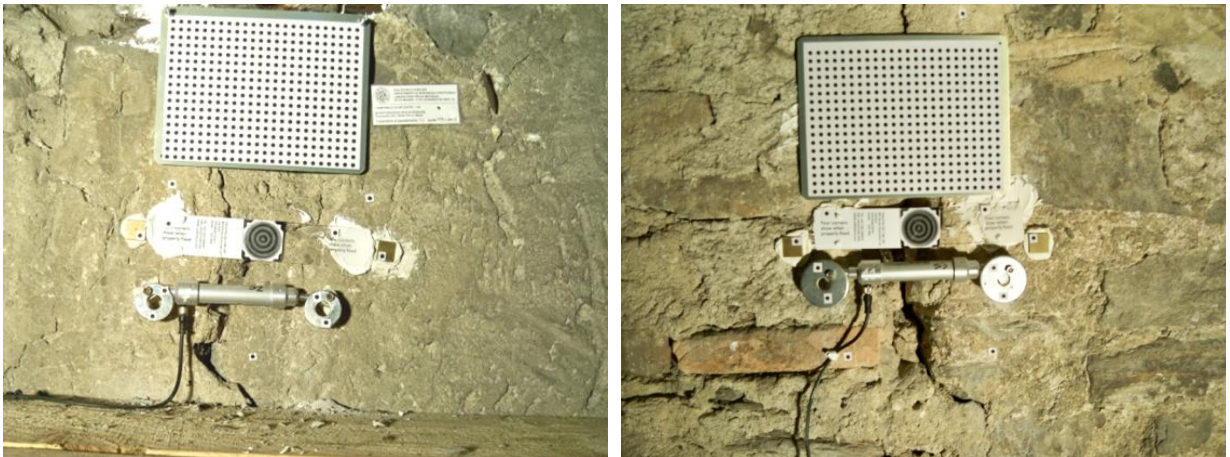
Figure 250 e 251 – Le due fessure oggetto di monitoraggio e tutti gli strumenti prima di iniziare le misure
