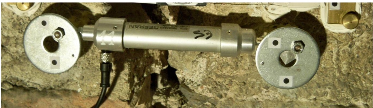
Figura 258 – Il trasduttore potenziometrico Gefran PZ67-S fissato sulla fessura S3 ad Arcisate
