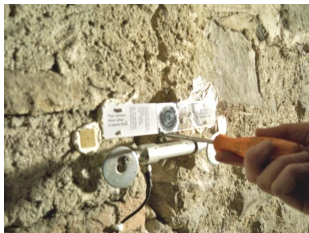
Figura 225 – Ultima fase di assestamento della posizione dei due componenti del fessurimetro moiré sulla fessura S3
