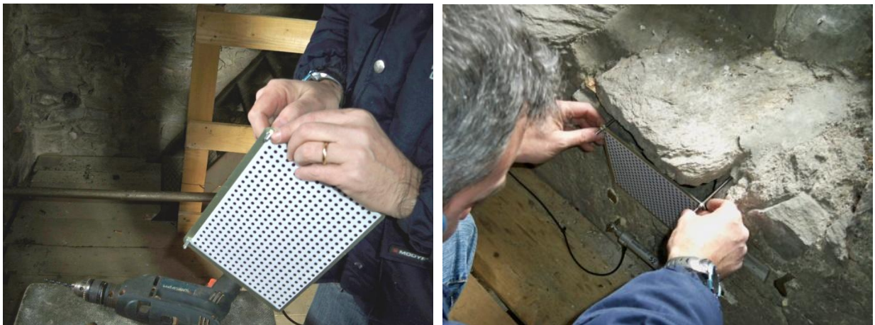
Figure 233 e 234 – Lo scorrimento delle rondelline sulle viti. A destra una prima prova di posizionamento nelle cavità che la fessura S2 presenta poco sotto l'apertura
