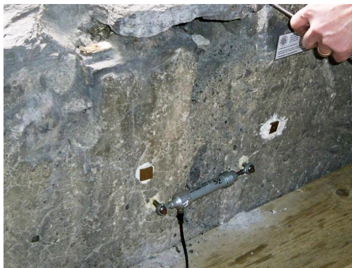
Figura 232 – La fessura S2 prima di iniziare le operazioni di fissaggio degli altri strumenti
