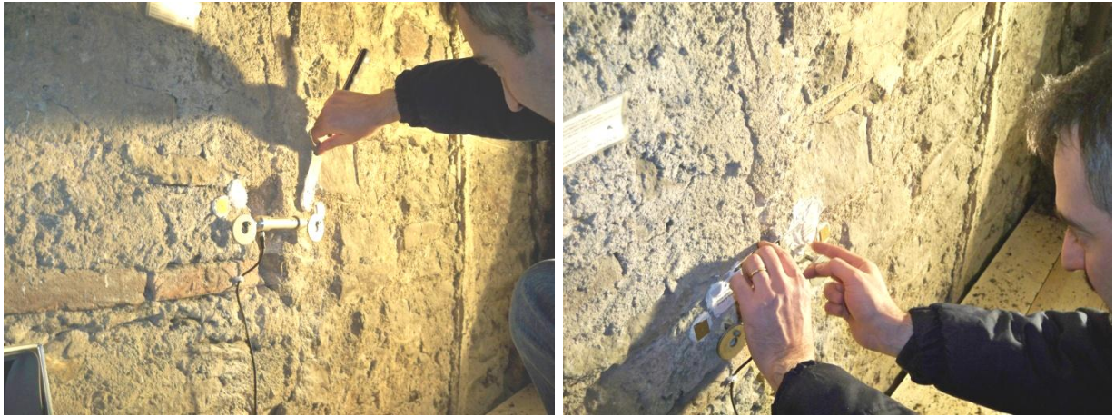
Figure 223 e 224 – Fase di incollaggio del fessurimetro moiré sulla muratura con mastice solido per marmi
