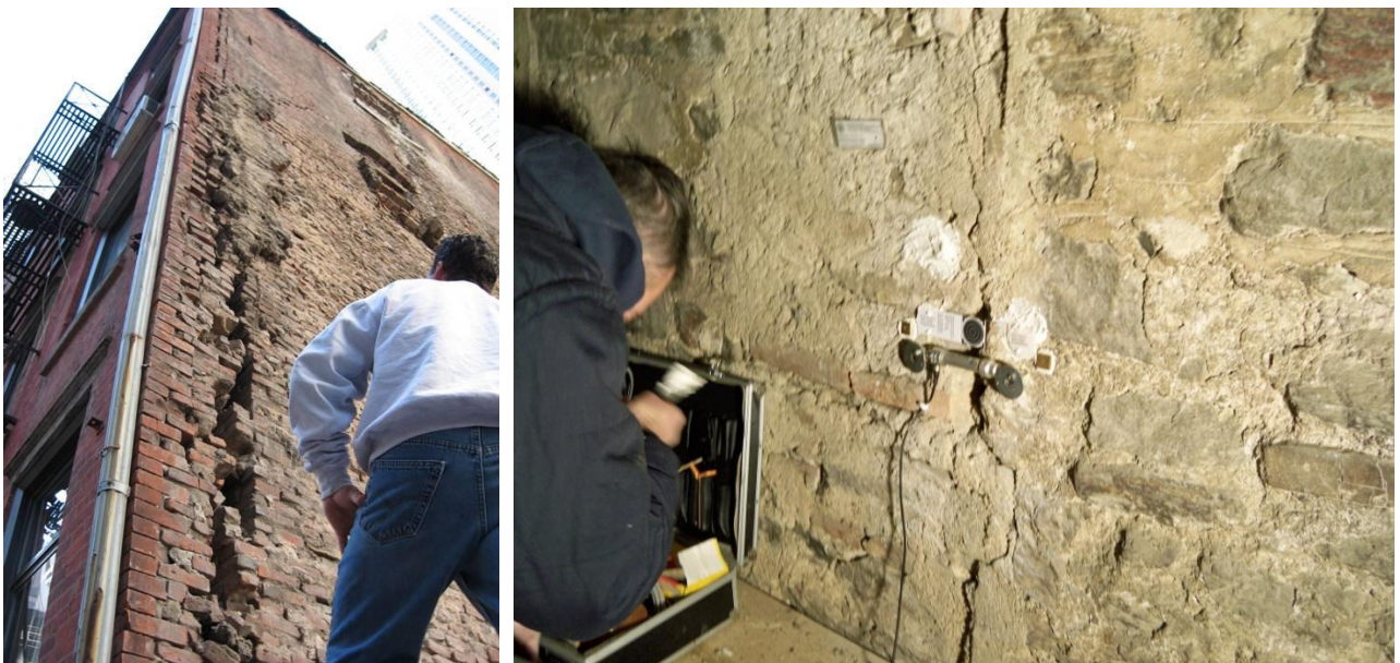
Figure 22 e 23 – Due esempi di fessure su murature portanti. A sinistra tutto il piano della facciata tende a distaccarsi dal resto dell'edificio. A destra una fessura causata dal peso proprio (andamento verticale) e che si sviluppa nelle zone deboli come la malta
