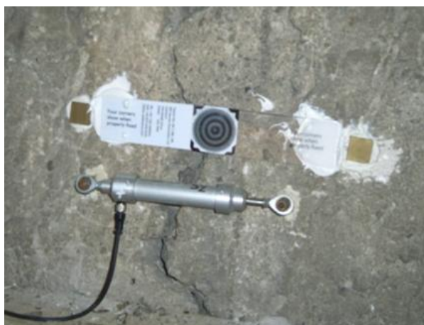
Figura 237 – Il fessurimetro moiré incollato sulla fessura S2
