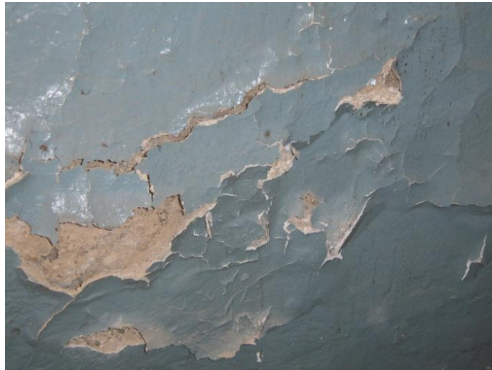
Figura 17 – Soluzioni di continuità e distacchi dello strato di finitura di un paramento esterno
