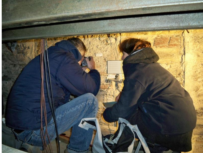
Figura 213 – Le difficoltà di accessibilità del punto in cui si trova una fessura sulla torre campanaria di S. Vittore
