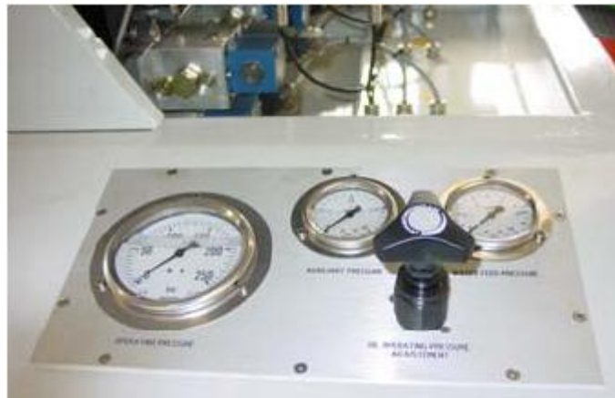
Figura 3. 11 Manometri presenti sul quadro comandi. In ordine da sinistra: pressione di lavoro circuito primario, pressione di lavoro circuito secondario, pressione alimentazione acqua
