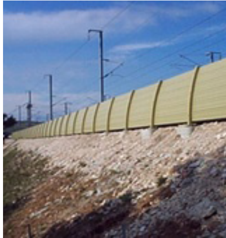
Figura 1.10 - Barriere antivento piene poste ai lati di un rilevato sulla linea LN5 Méditerranée.
