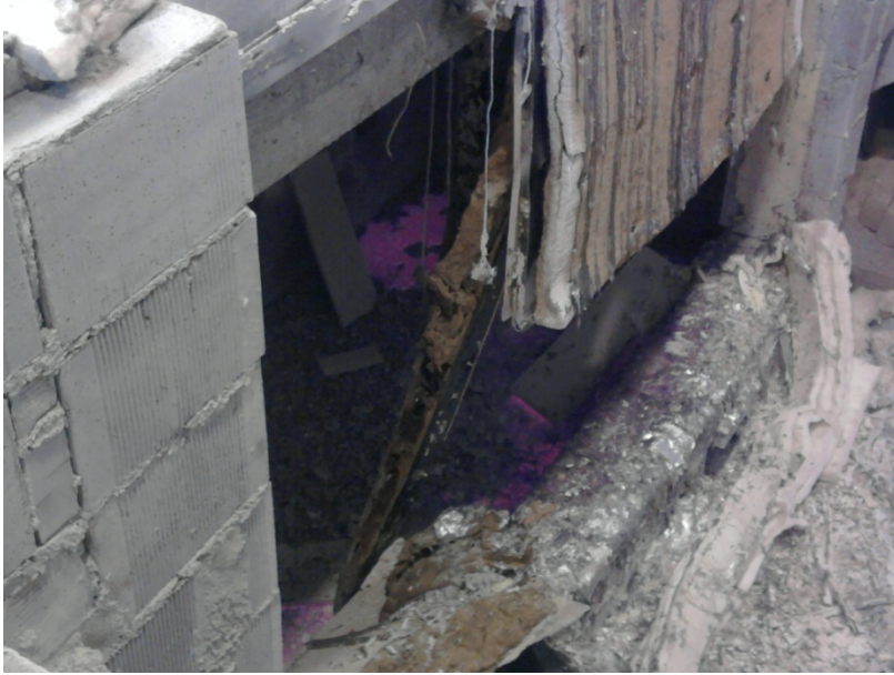
Figura IV-22 Facciata deteriorata dall'azione del fuoco
