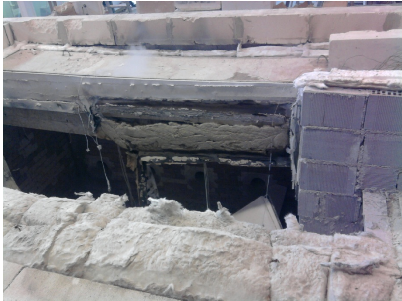
Figura IV-23 Particolare della soletta di chiusura deformata
