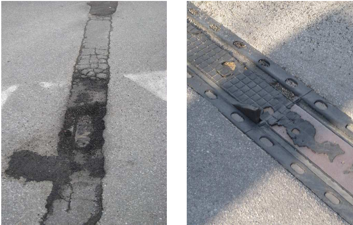
Figure 5.2: Giunti di espansione in cattive condizioni
