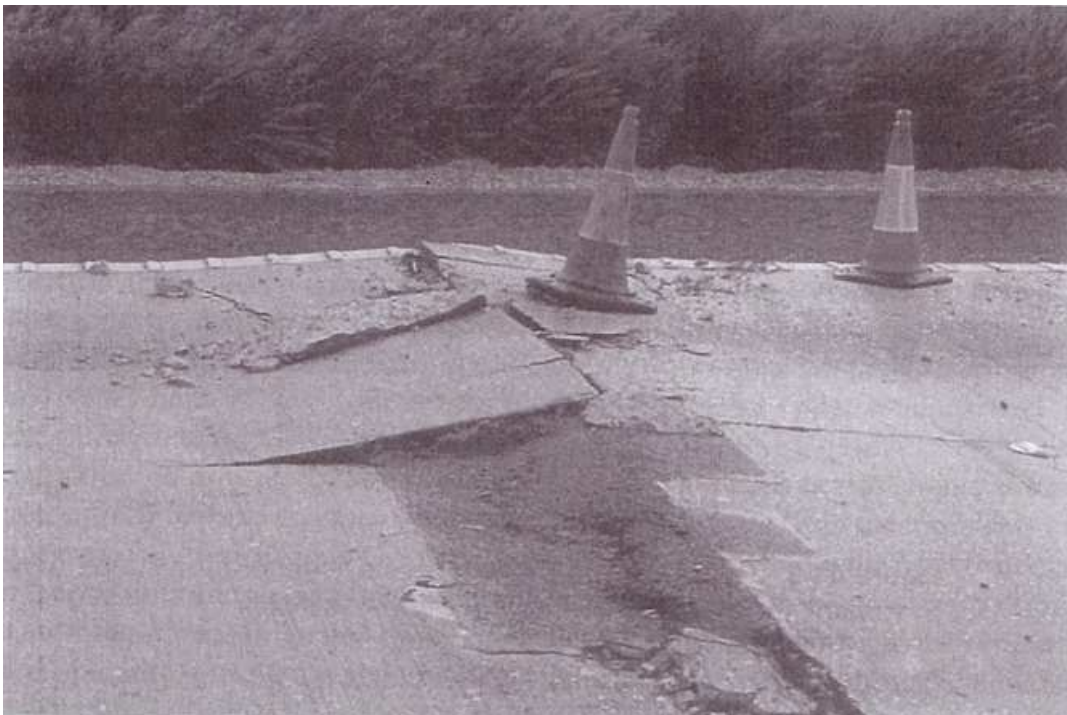
Figura 5.15: Rottura della pavimentazione sull'autostrada M11 ad Harlow -UK- (Burke, 2009)
