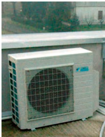
Fig. 335 – Unità esterna dell'impianto di condizionamento
