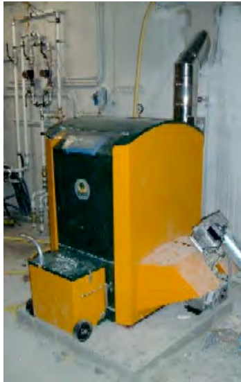
Fig. 295 – Caldaia a pellets
