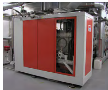
Fig. 164 – Imp. di cogenerazione
