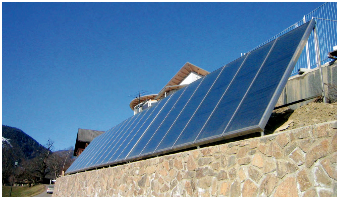
Fig. 265 – Particolare dei collettori solari per la produzione dell'acqua calda
