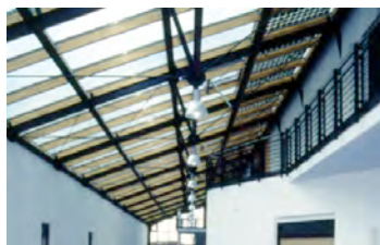
Fig. 162 – Cellule fotovoltaiche integrate nella copertura dell'atrio d'ingresso.
