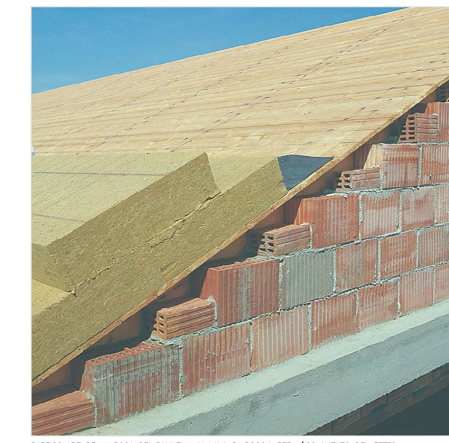
PARTICOLARE DELLA POSA DEI PANNELLI IN LANA DI ROCCIA PER L'ISOLAMENTO DEL TETTO
