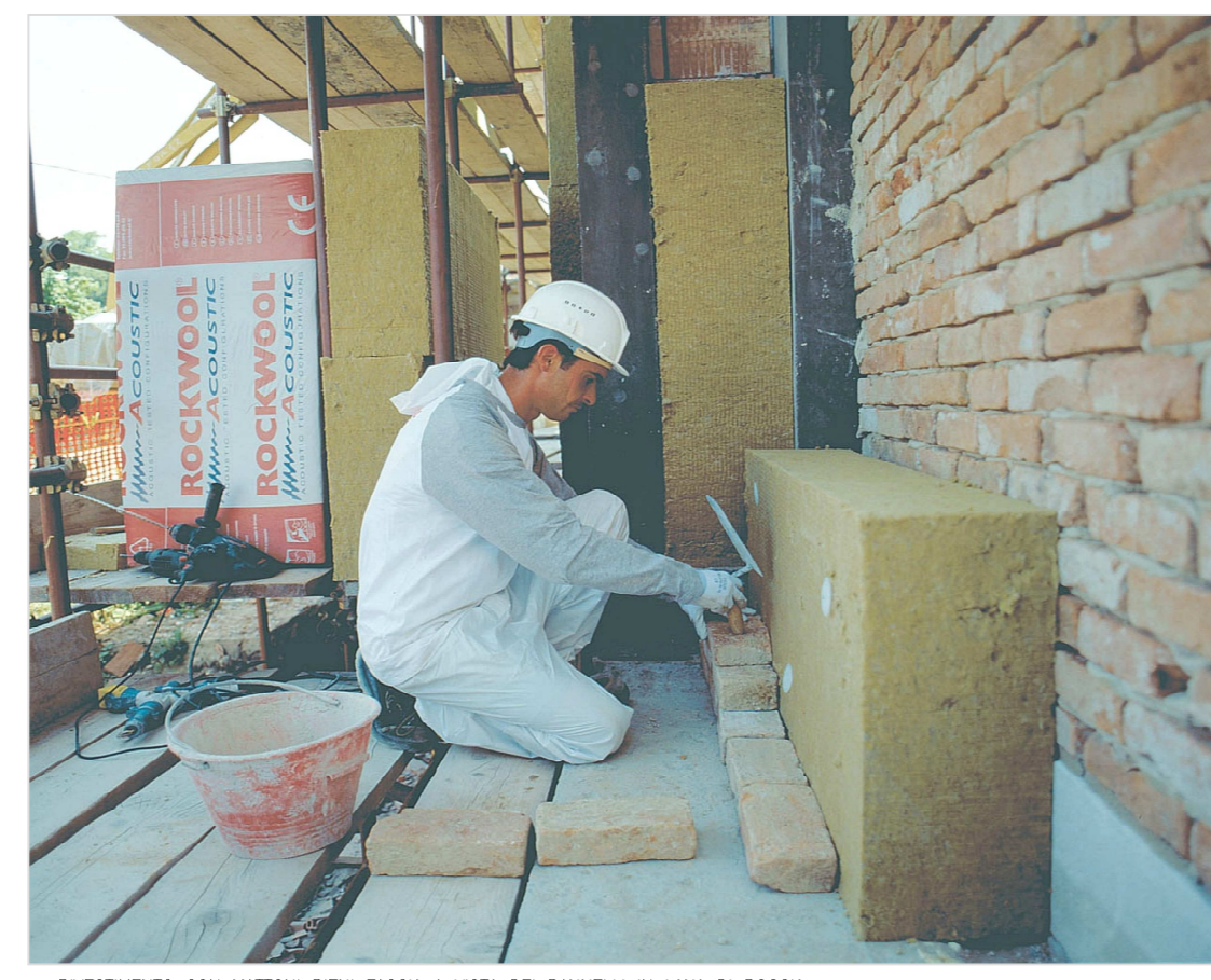
RINVESTIMENTO CON MATTONI PIENI FACCIA A VISTA DEI PANNELLI IN LANA DI ROCCIA
