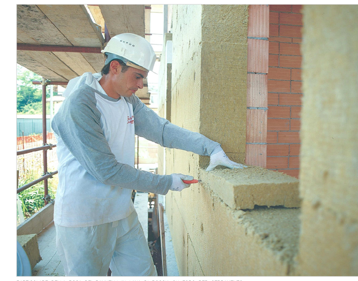
PARTICOLARE DELLA POSA DEI PANNELLI IN LANA DI ROCCIA SU FORO PER SERRAMENTO
