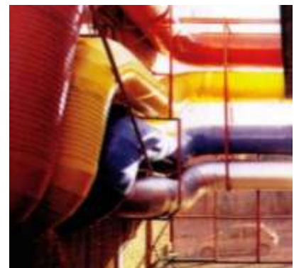
Figura 270 Particolare tubi areazione
