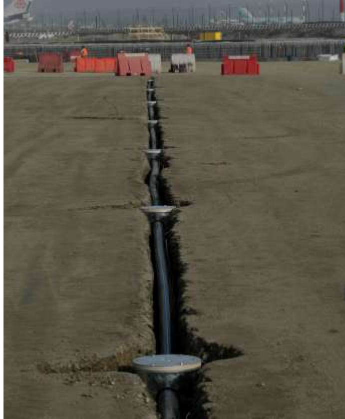
Figura 21: particolare dei cavidotti
