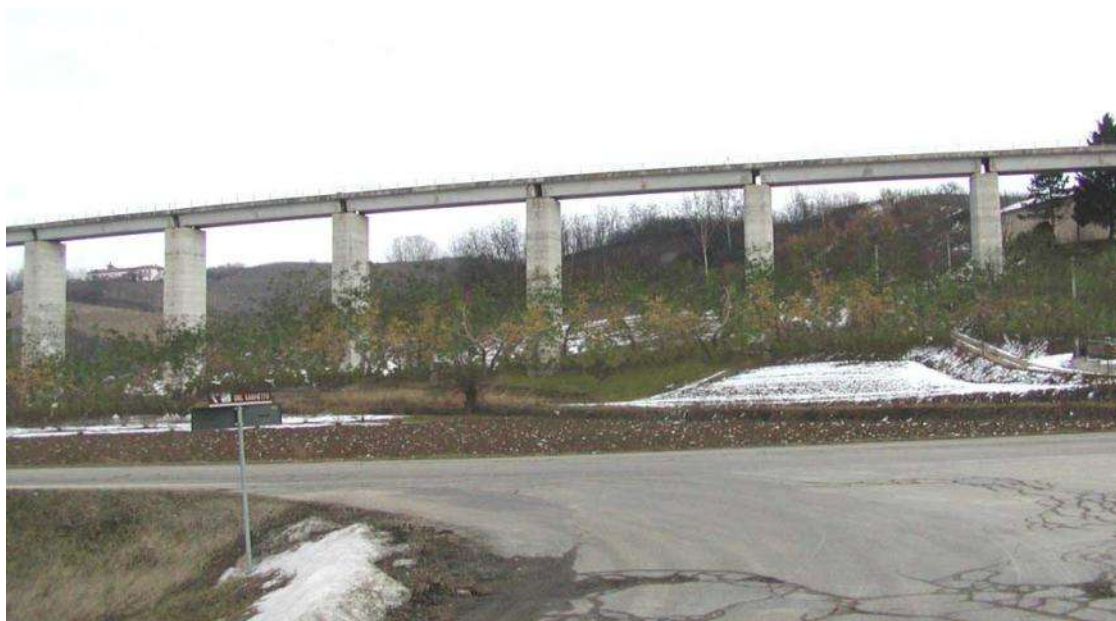
Dopo pochi anni dall'avvio degli interventi di mitigazione - Cavalcavia ferroviario Castagnole Lanze (AT)
