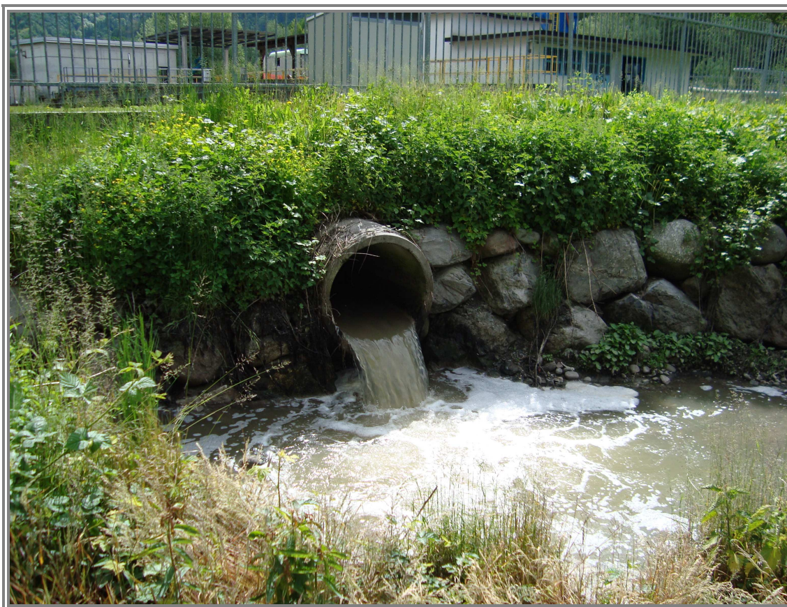
Figura 2.1: Scarico finale dell'impianto di depurazione delle acque.
