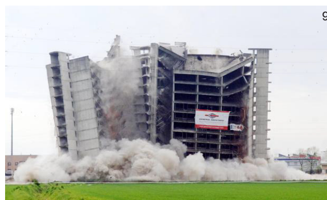
foto 9: demolizione del Blue Residence, San Giuliano Milanese, 2008. L'attività di demolizione è quella che origina il maggior flusso di rifiuti: tra 1000 e 2000 kg/mq, pari al 93% della produzione totale
