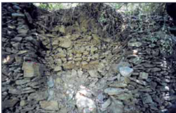
A seguito del crollo del paramento murario si può osservare come gli elementi del drenaggio (ancora in opera) fossero disposti di punta.
