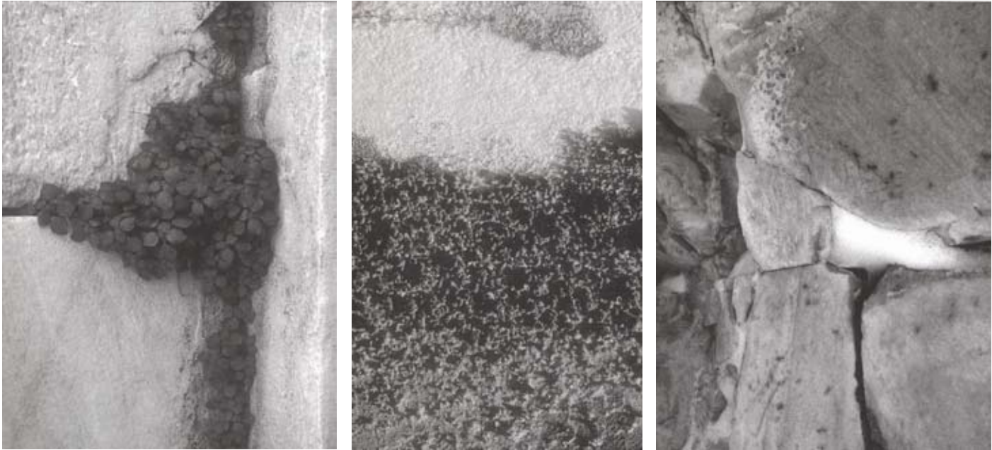
pagina precedente consolidamento della roccia sopra a sinistra danno biologico sopra centro danno chimico, particolare del colonnato nord in cui i grani del marmo hanno perso la loro coesione, come conseguenza di inquinamento atmosferico sopra destra danno meccanico allargamento delle crepe dovute dal ghiaccio
