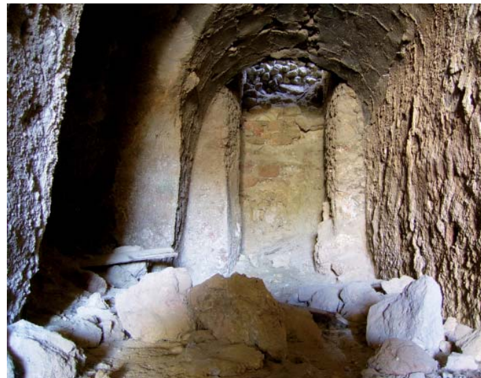
Figura 4.23. Canale di ventilazione.
