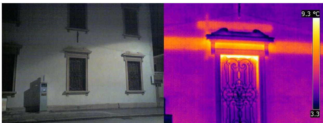
Figura 11 Dispersione termica dovuta al solaio e architrave sopra la finestra
