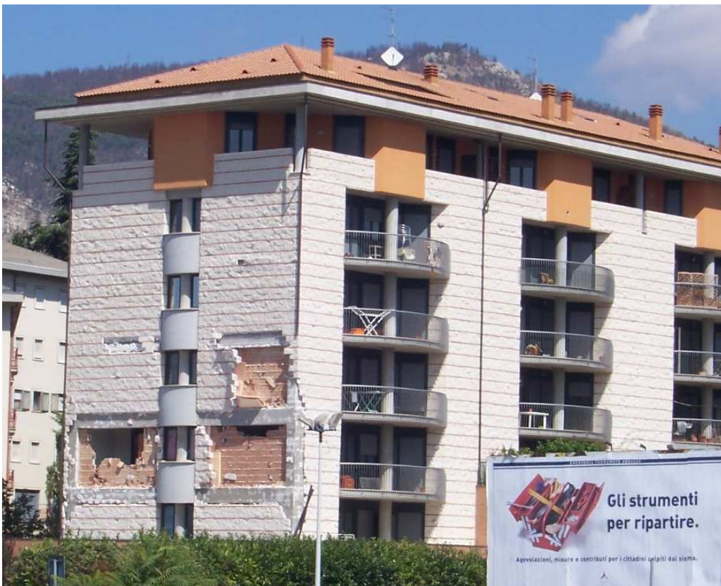
Figura 4.2. Struttura in cemento armato vicino alla stazione ferroviaria de L'Aquila con danni ai muri esterni ma struttura intatta (foto di inizio settembre 2009)
