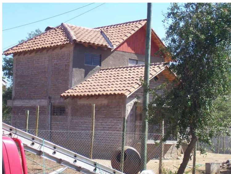
Figura 8.31. Marchihue. Casa in muratura confinata. Danno di grado 0
