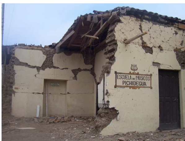
Figura 8.17. Esempio di una casa in adobe con danno di grado 5. Foto scattata a Pichidegua circa 10 giorni dopo la scossa del 27 febbraio
