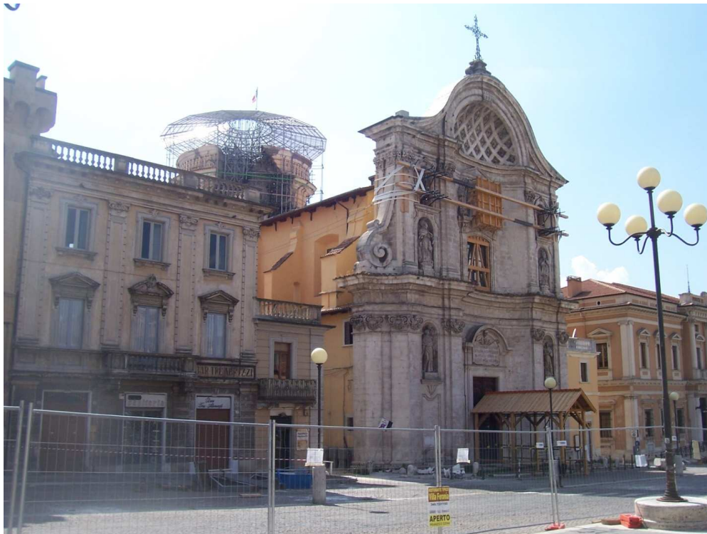
Figura 5.3. Chiesa di Santa Maria del Suffragio con la cupola in fase di ristrutturazione dopo i danni subiti in seguito al terremoto del 6 aprile (foto di inizio settembre 2009)
