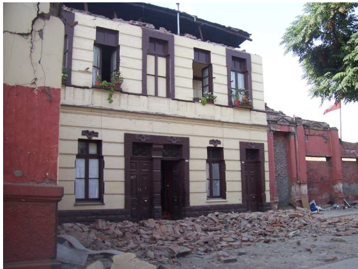
Figura 8.59. Danno ricorrente consistente nella caduta del parapetto. Foto scattata a Santiago il giorno stesso del terremoto
