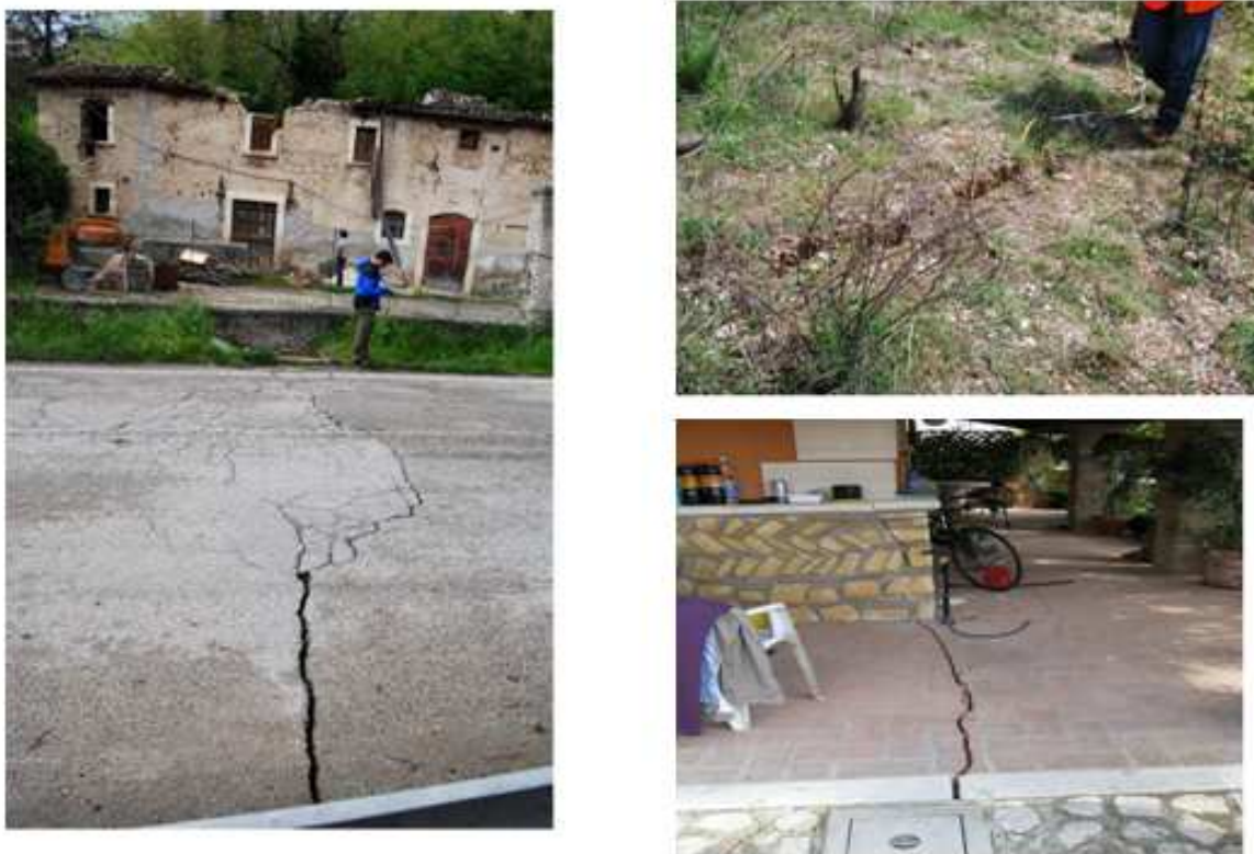
Figura 3.3, 3.4 e 3.5. Evidenza della faglia in superficie sul terreno, una strada e in una casa
