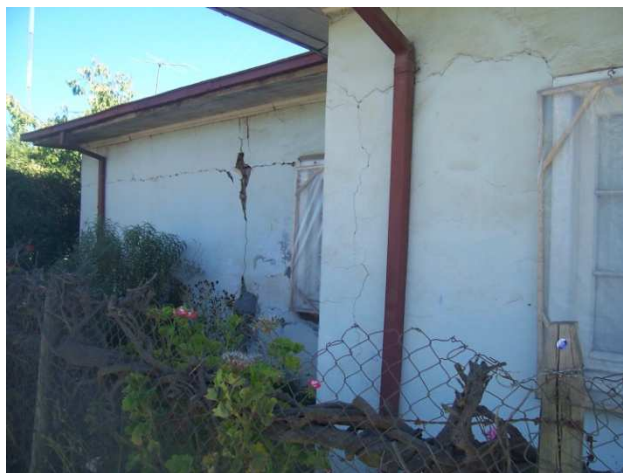
Figura 8.25. Las Cabras. Casa in adobe. Danno di grado 2
