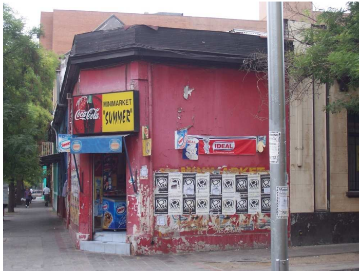
Figura 8.58. Casa in adobe nel quartiere universitario di Santiago. Danno di grado 1
