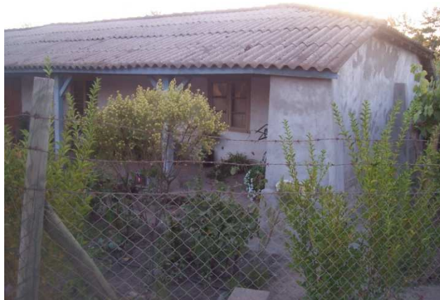
Figura 8.51. Pencahue. Casa in adobe con supporti laterali in cemento. Danno di grado 2
