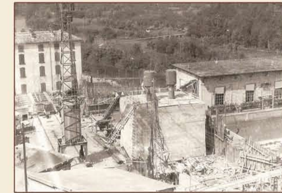
LA NUOVA CENTRALE IDROELETTRICA DELLA NIGGELER-KUPFER
