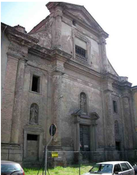
11.1.La facciata in condizioni precarie e pericolante
