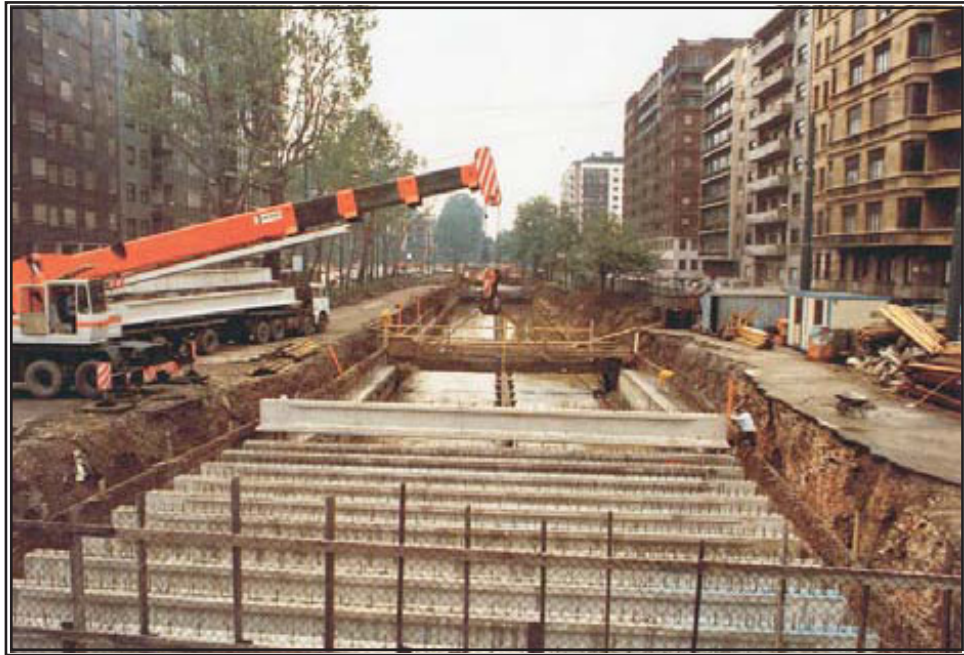
Lavori di sistemazione e copertura del cavo, Milano Rifacimento della copertura del cavo Redefossi in via Monte Santo, Milano, C.A.F.
