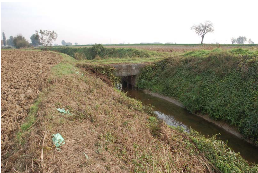
Figura 14 (5b_E_030): Il Colatore "Lame" con in primo piano uno dei numerosi ponticelli che lo attraversano. Il Colatore "Lame" scorre in direzione Est/ovest, contrariamente a tutti gli altri corsi d'acqua che attraversano il territorio di Rivarolo.
