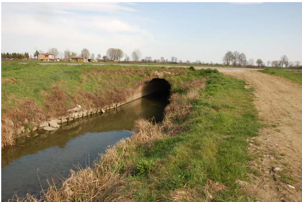
Figura 70 - (7f_E_068): Il canale Delmoncello ed il ponte lungo la strada provinciale n° 63 "Bozzolo – Sabbioneta". Sullo sfondo la cascina "Barco".
