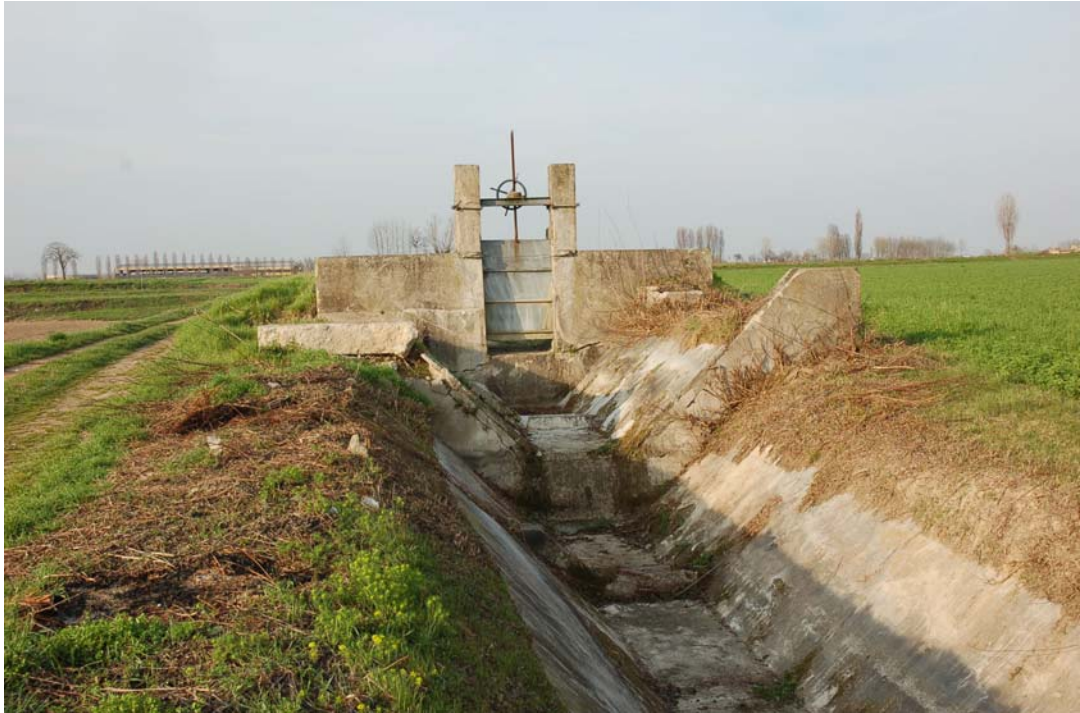
Figura 3 (6e_N_009) - Chiusa con stramazzo della canaletta di irrigazione del Consorzio di Bonifica Navarolo in prossimità della scarpata di paleoalveo
