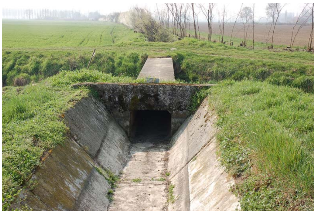
Figura 58 - (9a_S_012): L'immagine documenta una canaletta irrigua del Consorzio di Bonifica ed il manufatto di attraversamento sul canale Sabbionara, lungo il confine con Casteldidone.
